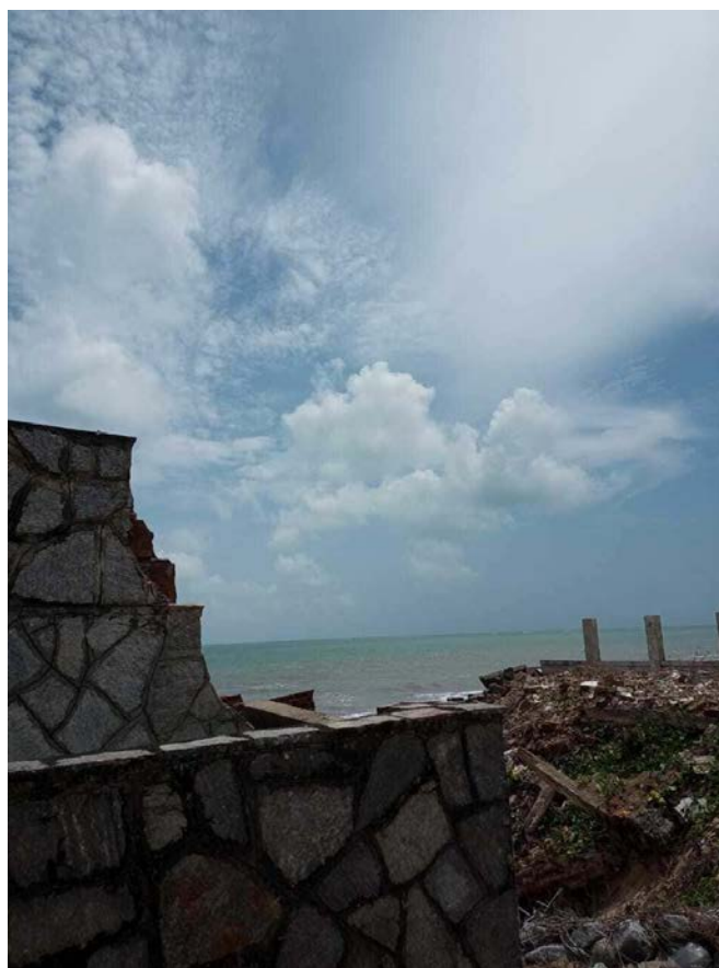
Figura 4. Entulhos de residência que sobraram depois de desabamento causado pelo processo erosivo. Foto: Ana L. E. Souza (2021).
