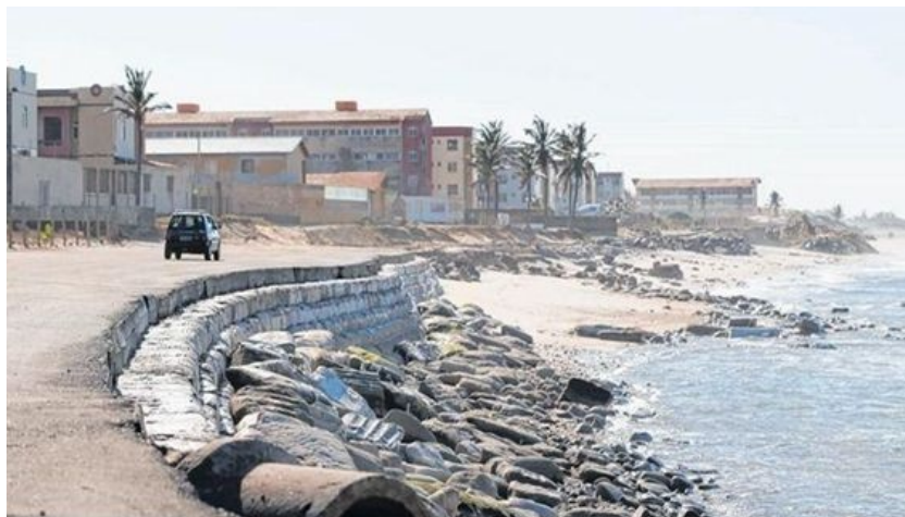
Figura 2. Tentativas de contenção à erosão costeira na orla do município de Icarai, CE.
