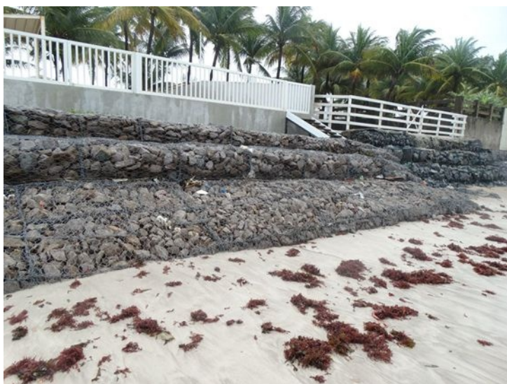
Figura 1. Obras de contenção à erosão costeira feitas por particulares. Este tipo de intervenção, sem um planejamento integrado, tende a causar efeitos colaterais nas áreas adjacentes, agravando o problema em escala municipal.
